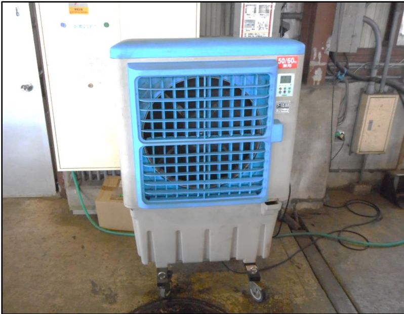
気化式冷風機の設置
